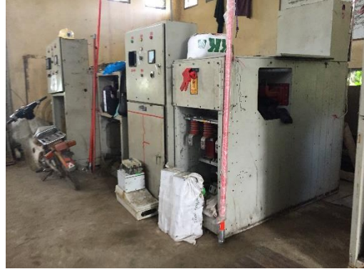
สถานีไฟฟ้าย่อย Shwe Pauk Kan
