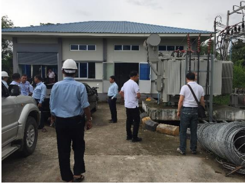
สถานีไฟฟ้าย่อย Wai Bar Gi
