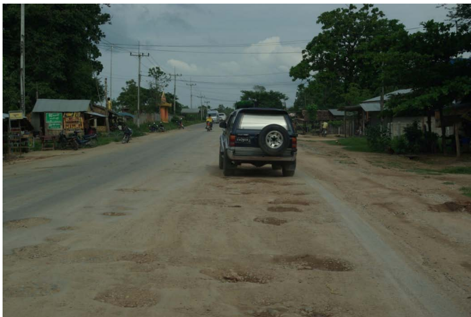
รูปที่ 2.5-9 สภาพถนนโครงการที่ชำรุด
